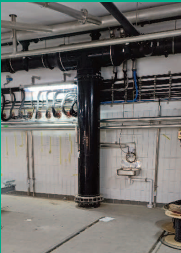
Verrohrung im Gebäude
