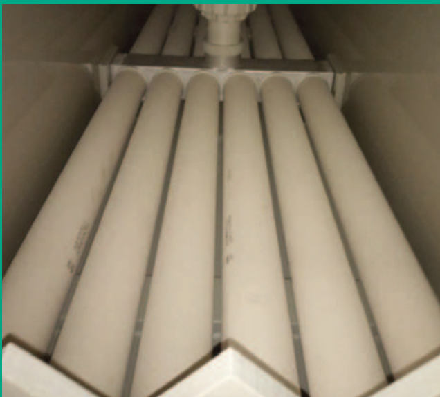
Belüfterkerzen in der Reaktionskammer
