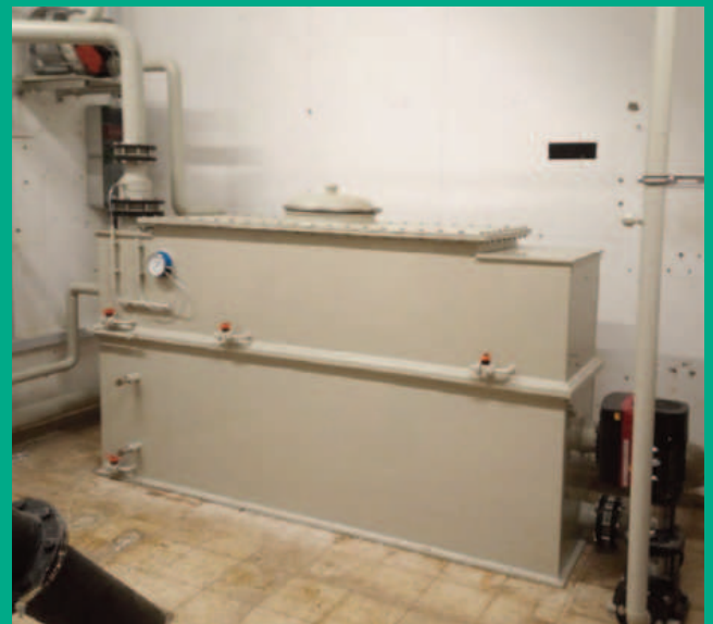
Flachbettbelüfter (li.) Seitenkanalverdichter mit pH-Sonde (re.)
