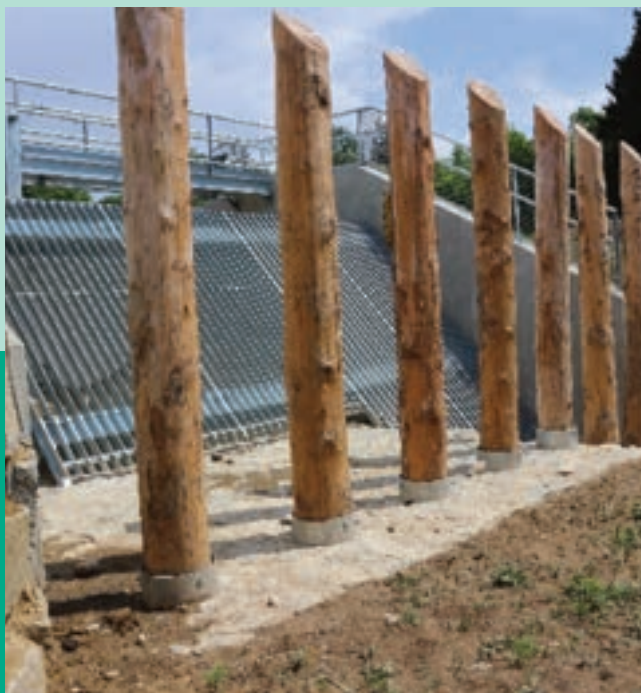
Abbildung 2: HRB Bachern, Bayern (li); HydroSlide® Abflusssteuerung mit Amphibienschleuse (re)
