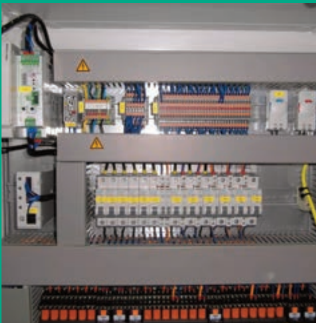
control cabinet: wiring
