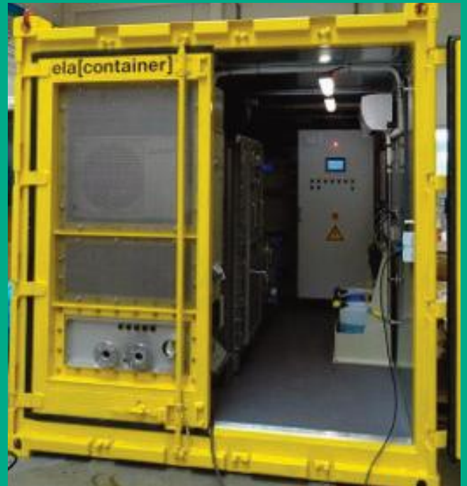
Container in Sonneberg vollständig ausgerüstet
